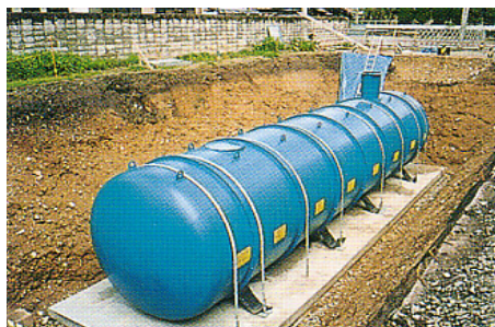
耐震性貯水槽
